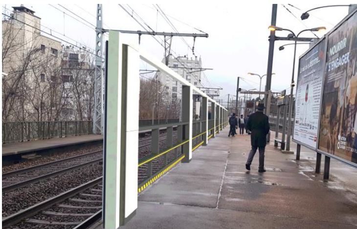
7 portes palières de 8m de longueur et 1,6m de hauteur, avec des parois de verre pour sécuriser les quais de la gare. ©SNCF
